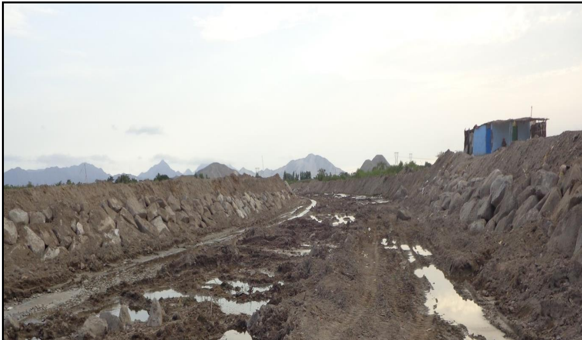
FOTO 32: se muestra una de las actividades de Prevención 2015-2016, Protección con roca ambas márgenes río Huamanzaña, sector San Carlos, en ejecución.
