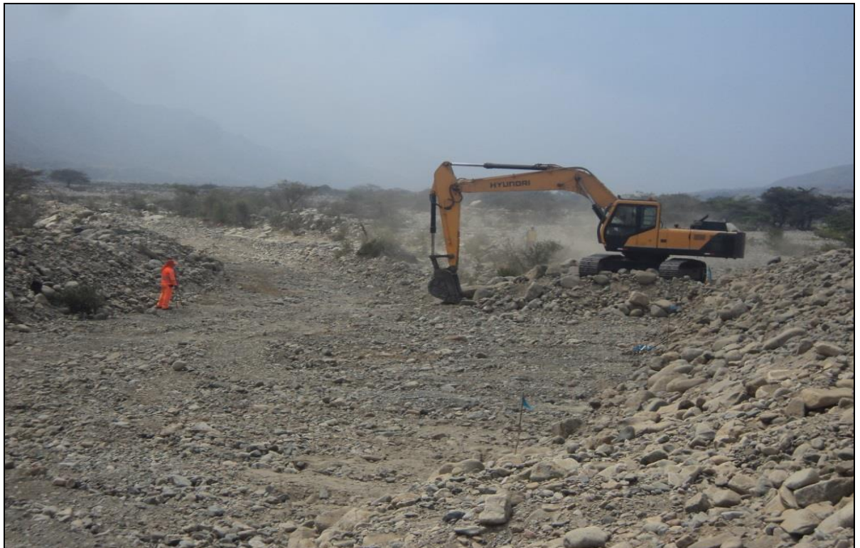
FOTO 08: se muestra una de las actividades de Prevención 2015-2016 en la Quebrada Quirripano, Parte Alta, durante la ejecución (terminado)
