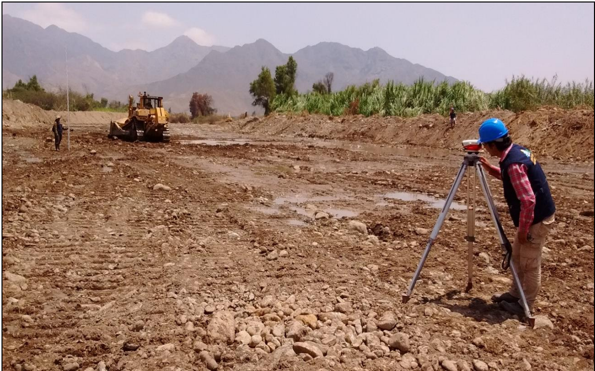
FOTO 27: se muestra una de las actividades de Prevención 2015-2016 en río Virú, tramo toma San Nicolás, Sector San Nicolás, Terminado.
