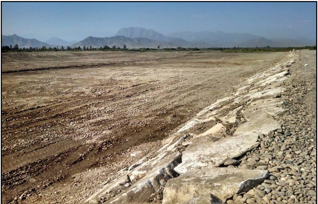
FOTO 18: se muestra una de las actividades de Prevención 2015-2016 en río Chicama, sector Cañal, terminado.
